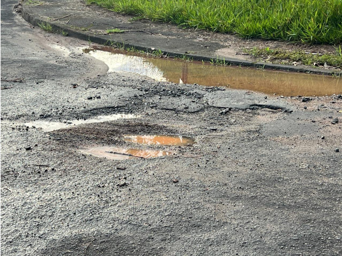
Imagem 7: Detalhe da pavimentação na intersecção das ruas Professor Agenor Augusto de Araújo; Rua Jerônimo Mariano Leite e Rua Alcides Nogueira devido ao tráfego de caminhões pesados sem limitação de carga e/ou autorização.
