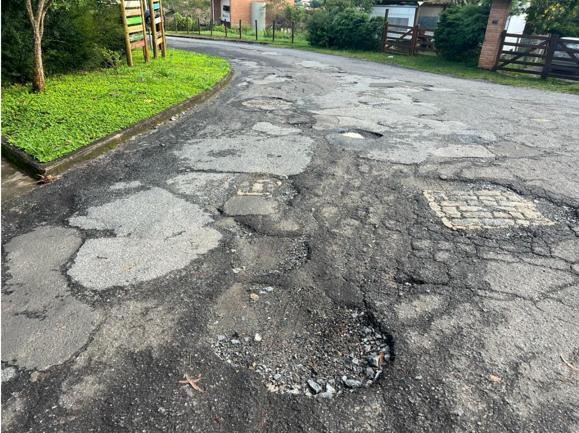
Imagem 6: Detalhe da pavimentação na intersecção das ruas Professor Agenor Augusto de Araújo; Rua Jerônimo Mariano Leite e Rua Alcides Nogueira devido ao tráfego de caminhões pesados sem limitação de carga e/ou autorização.
