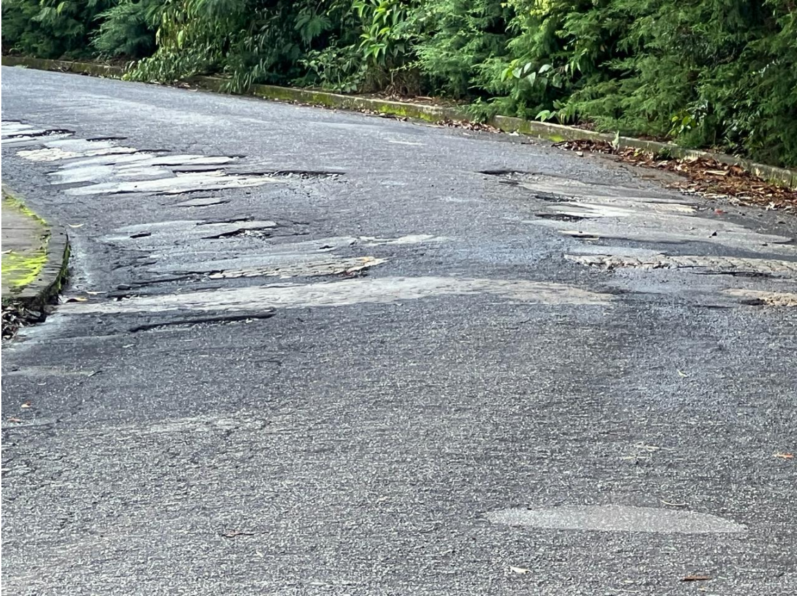
Imagem 8: Detalhe da pavimentação na intersecção das ruas Professor Agenor Augusto de Araújo; Rua Jerônimo Mariano Leite e Rua Alcides Nogueira devido ao tráfego de caminhões pesados sem limitação de carga e/ou autorização.
